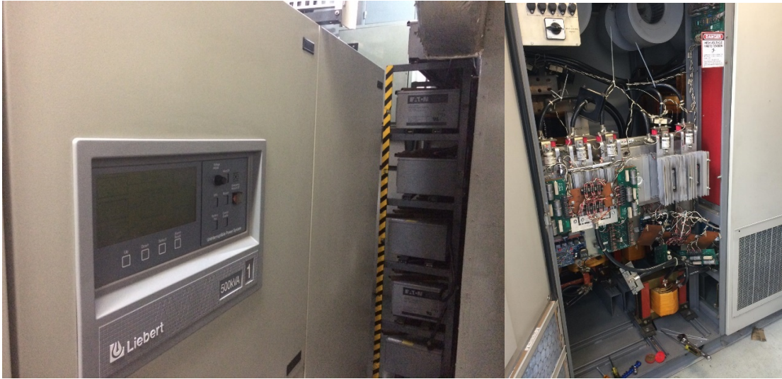
UPS 338 KVA Y 500 KVA
