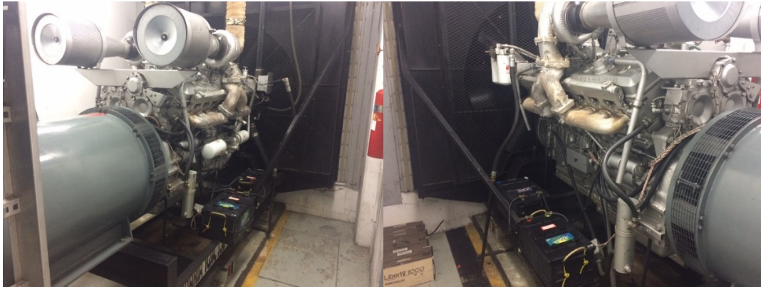
Plantas de emergencia 600 KVA y 800 KVA
